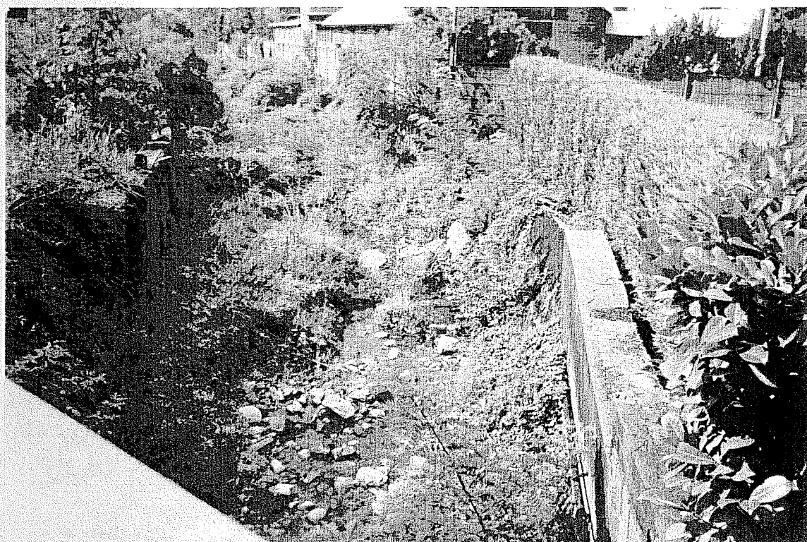
o 006 – Rio Magiaica muro spondale profondamente lesionato TAMOPO005
